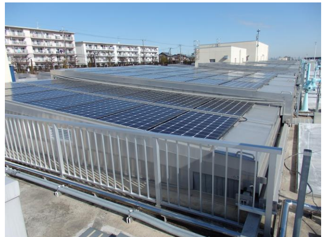
長沢浄水場のろ過池上部に設置された太陽光発電設備
