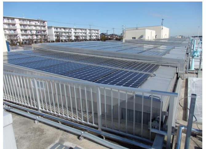
長沢浄水場のろ過池上部に設置された太陽光発電設備
